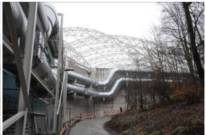
Abb. 2: Lüftungsrohre zur Unterdruckhaltung
